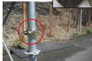
④ 完全に直交リベットが破断。
